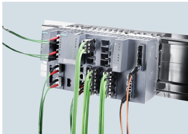
Cable de conexión FO Cord SC/SC entre XC100-4OBR y SCALANCE X320-3LD
